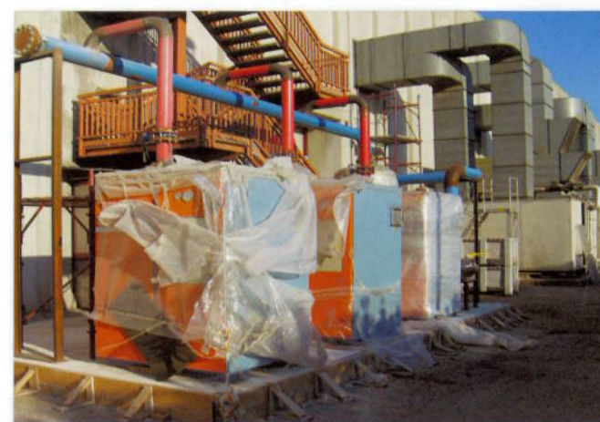
Le pompe per vuoto on site.
