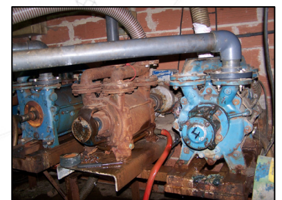
Foto 4 - Detalle de las bombas substituidas
