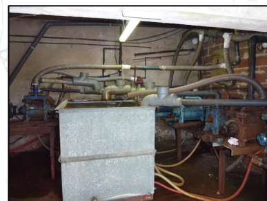
Foto 3 - Impianto precedente ad anello liquido
