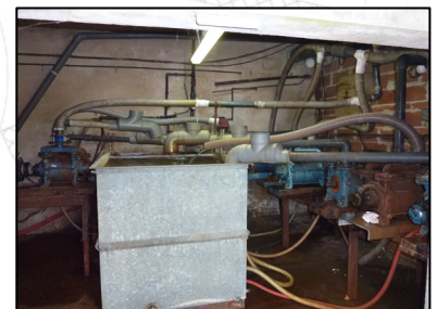
Фото 3 – Ранее используемый водокольцевой вакуумный насос
