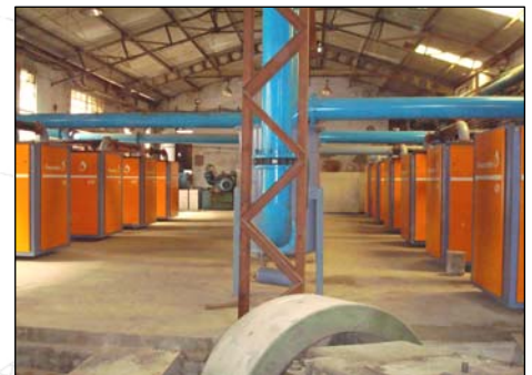
Pumpenraum mit 10 x UV50 VS90 HC
