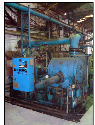
Bombas Wittig WPSO substituidas
