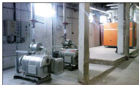
Links veraltete Pumpen Rechts neue UV30 VS55
