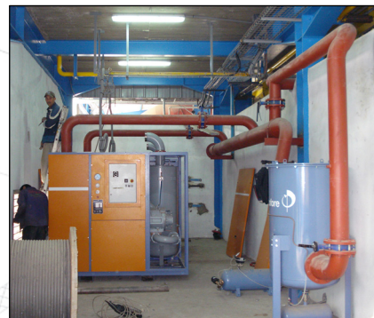
Pumpenraum mit zwei UV30 Pumpen aus dem Jahr 2010
