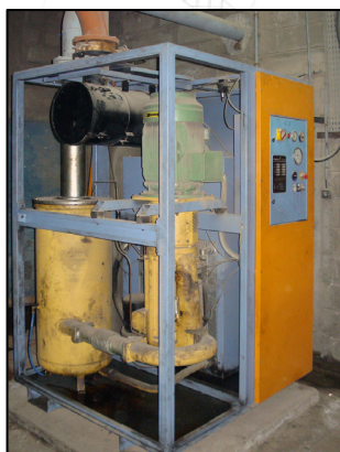
Die luftgekühlten UV16 Vakuumpumpen des Jahres 2003
