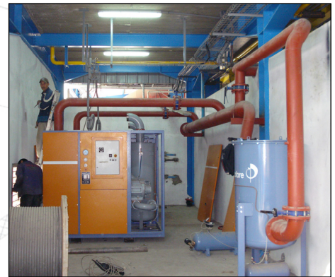
Sala máquinas con 2 x UV30 en 2010
