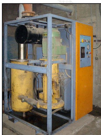
Pompa UV16 raffreddata ad aria, installata nel 2003
