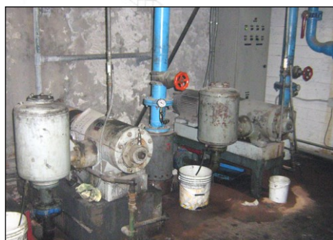
Zwei wassergekühlte V45 Pumpen aus dem Jahr 1963
