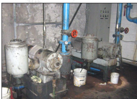
Due pompe V45, del 1963, raffreddate ad acqua
